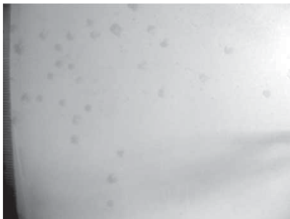
図1 変色した塗装鋼板の外観写真
