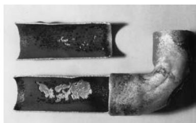
写真1 銅管内面(管径はφ20mm)
